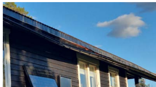
Nedbøyning i renne.
