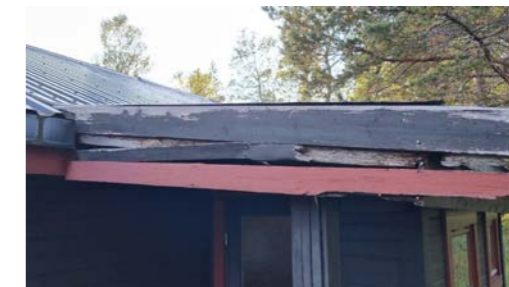
Råteskade i vindskibord.
