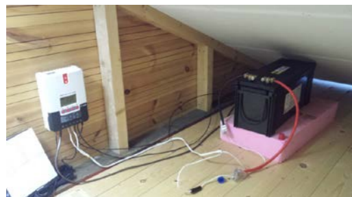
Laderegulator og batteri plassert på hemsen.
