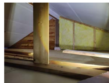
Åpen isolasjon i det ene hemsrommet.
