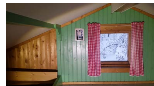
Manglende innvendig reguleringslokk på ventil på hemsen.
