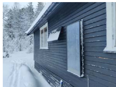
Solcellepanel for solcelleanlegget og solvarmer.
