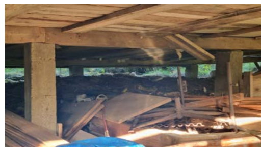
Skjevheter i enkelte peler.
