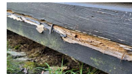
Råteskade i ytterkledning.
