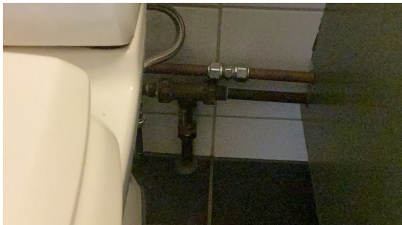
Stoppekran på bad.
