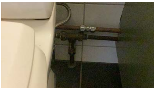
Stoppekran på bad.
