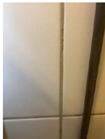
Eksempel på oppsprekking i hardfuge.
