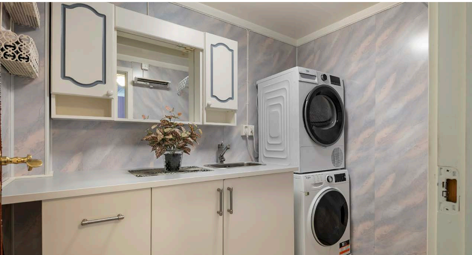
Opplegg for vaskemaskin og tørketrommel.
