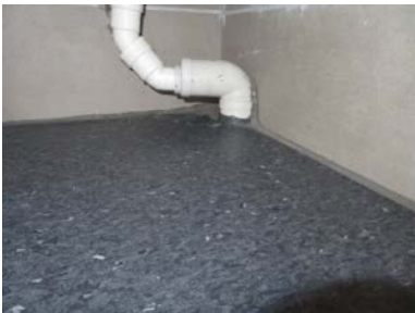
Belegg ved rør-gjennomføring.
