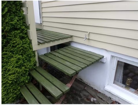
Mangler rekkverk på terrassedel ved trapp TG-3.
