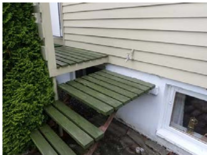
Mangler rekkverk på terrassedel ved trapp TG-3.
