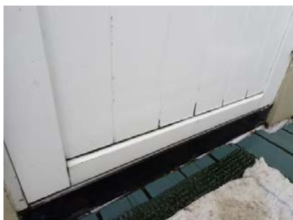
Svelling i nedre del av balkongdør etablert i
