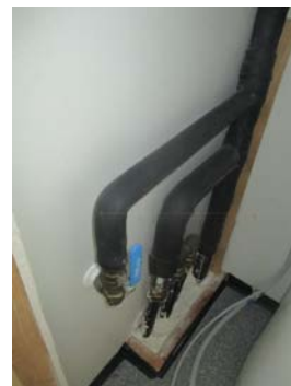
Stoppkran i skap på hotellrom
