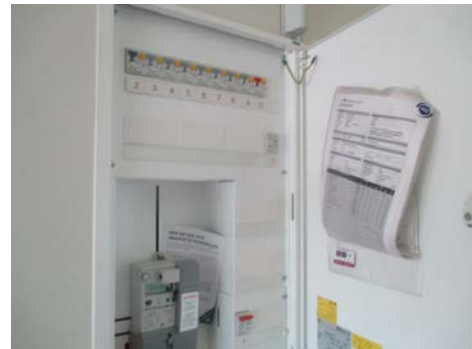
Sikringsskapet er plassert ved kjøkken og har merkede kurser.
