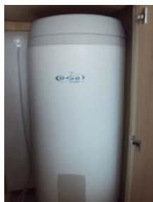
Bereder er plassert i et skap på hotellrom.
