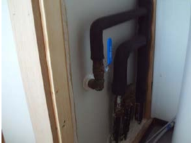
Innvendig stoppekran i et skap på hotellrom.
