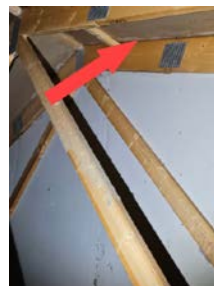
Fuktmerker i gips i skillevegg mot nabo.
