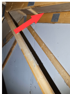
Fuktmerker i gips i skillevegg mot nabo.
