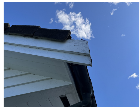
Råteskade i vindski
