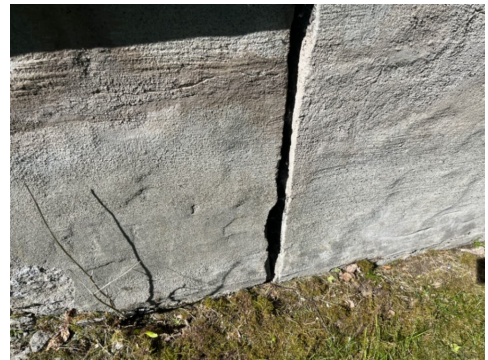
Sprekker i fundament terrasse.
