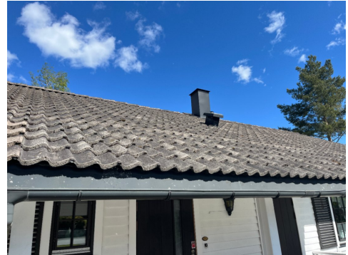
Manglende snøfangere og takstige.
