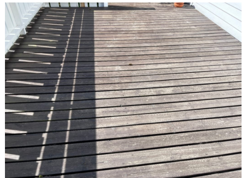
Værslitasje på gulv.
