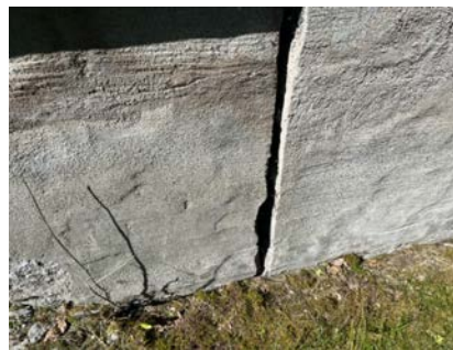
Sprekker i fundament terrasse.
