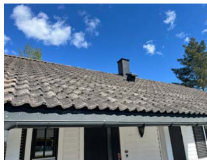
Manglende snøfangere og takstige.
