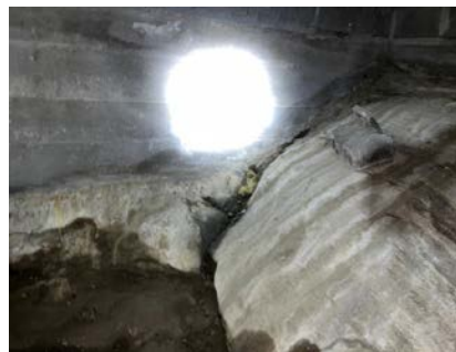
Synlig tegn på fuktighet følger fjell inn i krypkjeller
