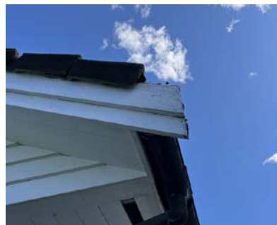
Råteskade i vindskier
