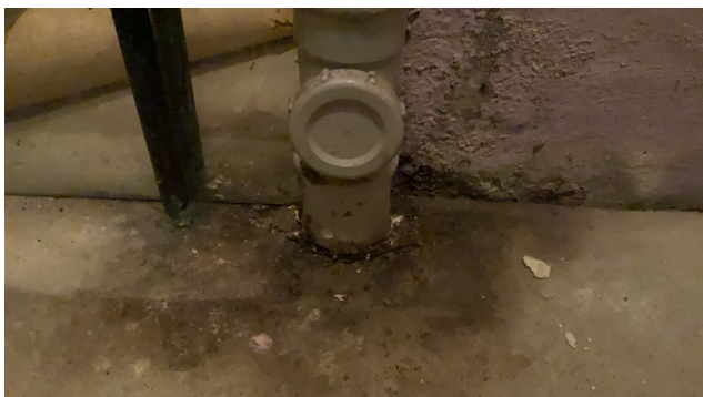
Lekkasje på avløpsrør i bod i U. etasje.
