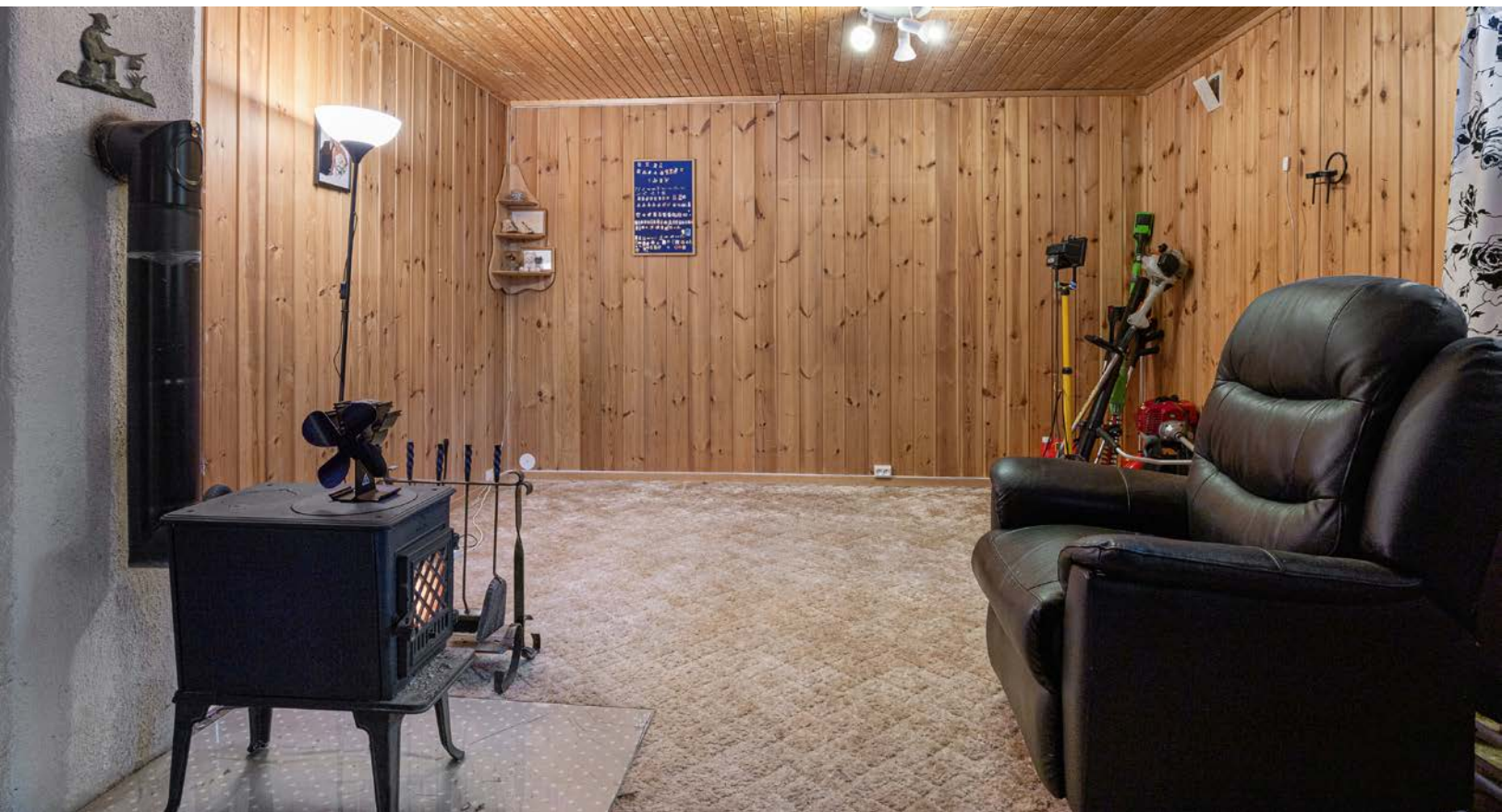
I underetasjen har boligen et innredet rom med vedovn i bruk som kjellerstue. Rommet er ikke godkjent for varig opphold og fremkommer som hobbyrom på tegninger.
