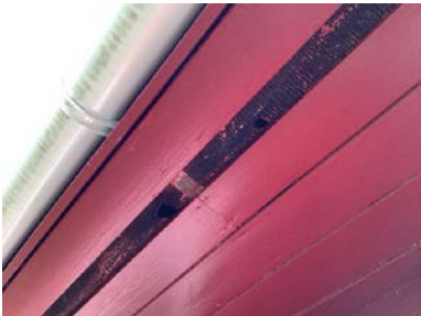
Det er åpninger i raftekasse, netting er morken
