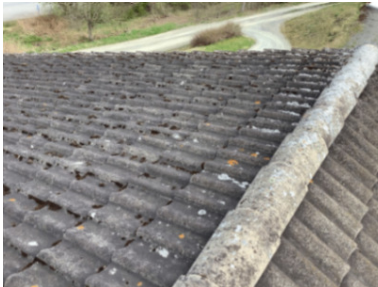
Mose og slitt overflate.
