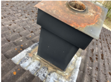
Rust på pipebeslag.
