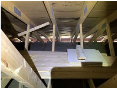
Bra lufting på kaldt loft.
