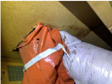
Kondensmerker ved luftelyre, disse var tørre på befaringen.
