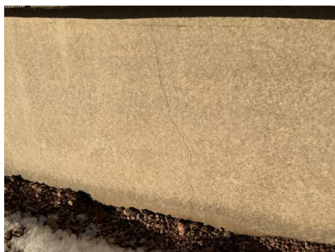
Sprekk i ringmurselement.
