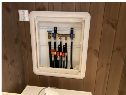
Fordelerskap i vegg på bad.
