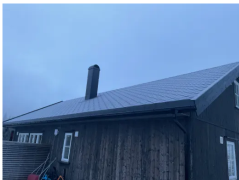
Manglende adkomst for feier og snøfanger.
