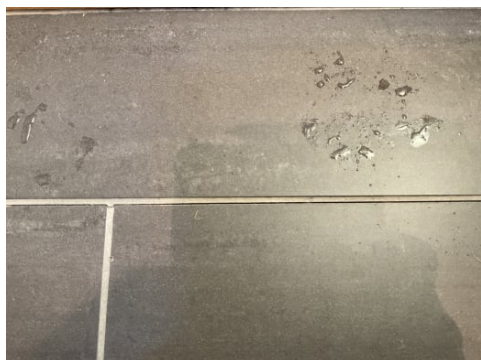
Sprekker i fuger ved inngangsdør.
