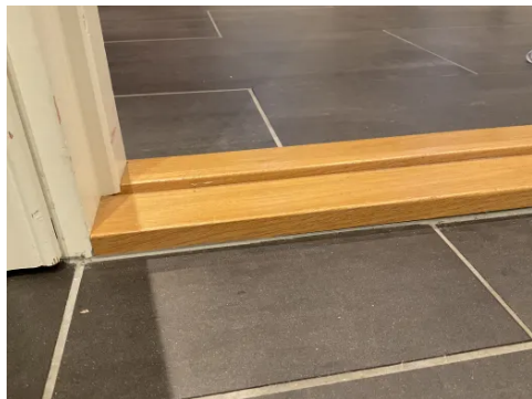
Ingen synlig membran ved terskel.
