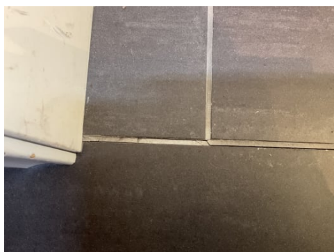
Sprekker i fuger ved inngangsdør.
