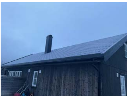
Manglende adkomst for feier og snøfanger.
