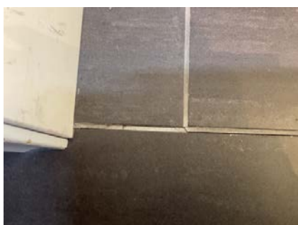
Sprekker i fuger ved inngagsdør.
