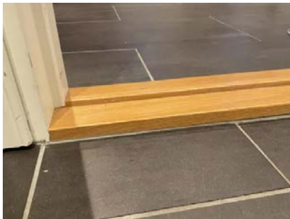
Ingen synlig membran ved terskel.
