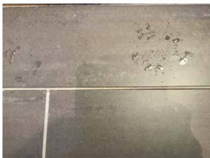
Sprekker i fuger ved inngagsdør.
