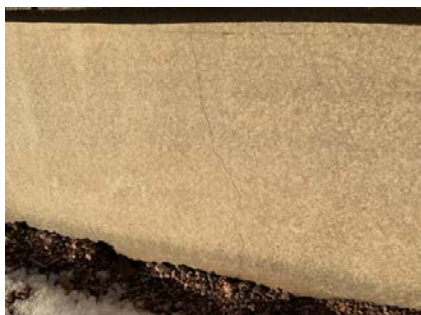
Sprekk i ringmurselement.
