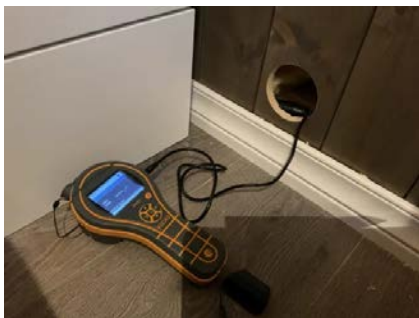
Hultaking i tilstøtende rom.
