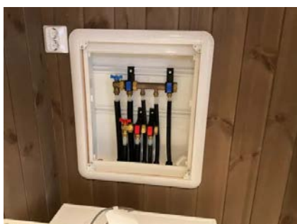
Fordelerskap i vegg på bad.
