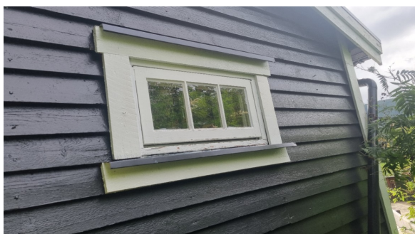
Vindu er værslitt
