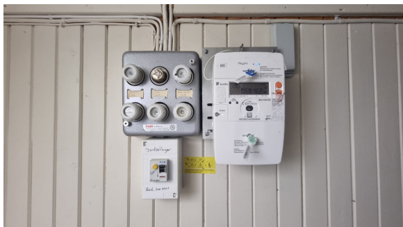
Sikringer, jordfeilbryter og måler.
