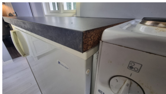
Benkeplaten mot komfyren har ikke avsluttende kanting.
