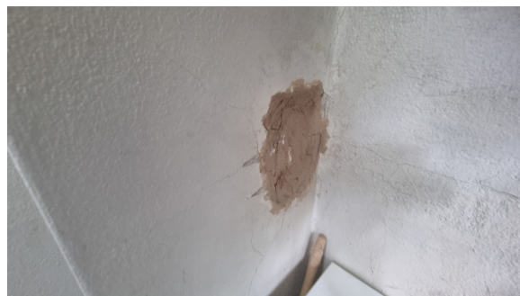
Det er registrert hull i pipa etter tidligere røykrør som er tettet, men det er usikkert om tettingen er utført på en tilfredsstillende måte.
