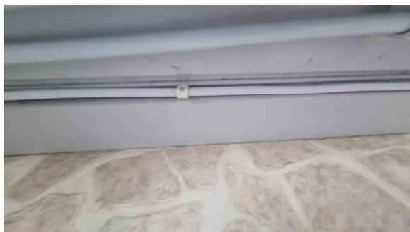
Belegget har ikke oppkant.
