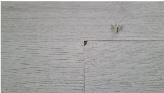
Skade i gulv
