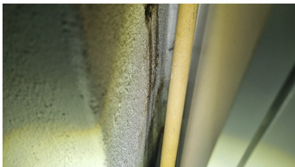
Det er rennemerker fra sotluke.
