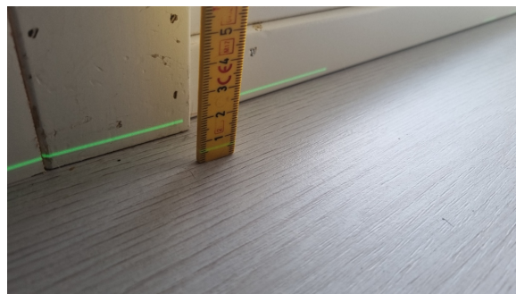
Kontroll av planavvik.
