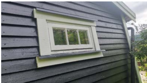
Vindu er værslitt
