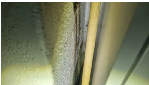
Det er rennemerker fra sotluke.
