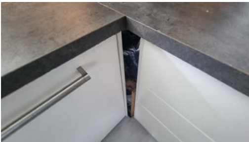
Det mangler foring i de innvendige hjørnene mellom benkeskapene.
