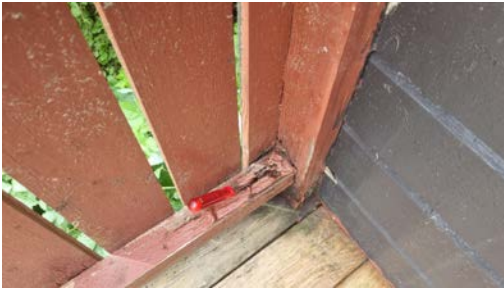
Råteskade i rekkverk.
