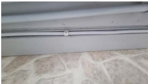
Belegget har ikke oppkant.
