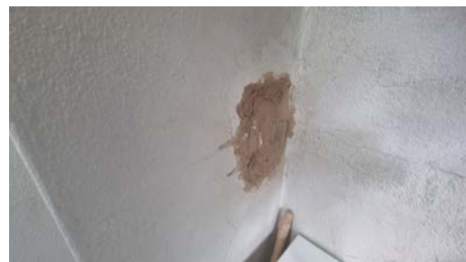
Det er registrert hull i pipa etter tidligere røykrør som er tettet, men det er usikkert om tettingen er utført på en tilfredsstillende måte.
