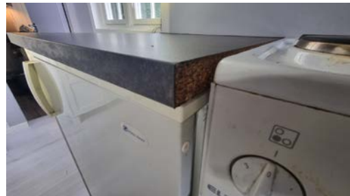
Benkeplaten mot komfyren har ikke avsluttende kanting.
