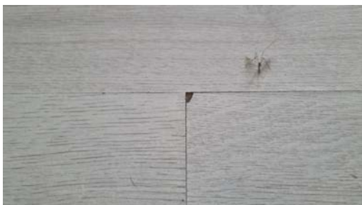
Skade i gulv
