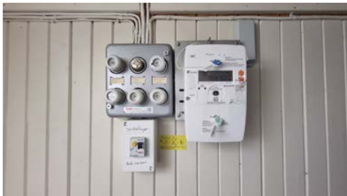
Sikringer, jordfeilbryter og måler.
