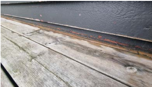
Det er registrert at det ikke er montert beslag i overgang mellom yttervegg og terrasse.
