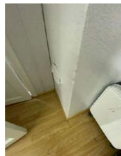
Ildplate under feieluke bør opparbeides.
