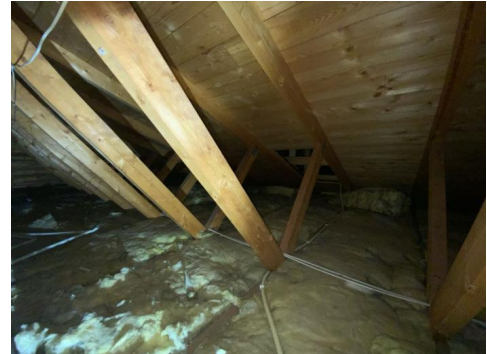
Deler av tilbygget tak lot seg ikke kontrollere grunnet manglende gulv og lav takhøyde. Nærmere kontroll bør utføres.
