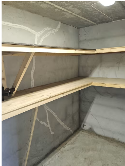
Det registreres riss/sprekker på grunnmur i sportsbod.
