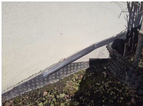
Bilde viser løs topplatt og skadet knotteplast.
