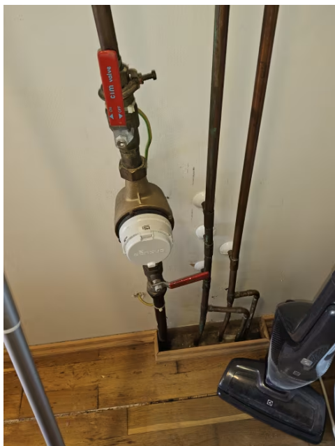
Hovedstoppekran er plassert på bod.
