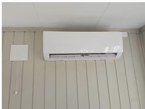
Varmepumpe er plassert i stue.
