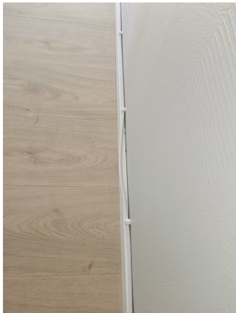
Det er benyttet fastmontert gummikabel mellom stikkontakter på soverom.
