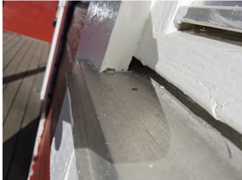
Ingen klaring mellom utvendig belistning og vannbrettbeslag.
