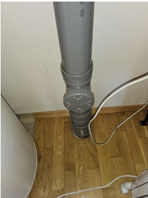
Stakeluke er plassert på avløpsstamme i bod.
