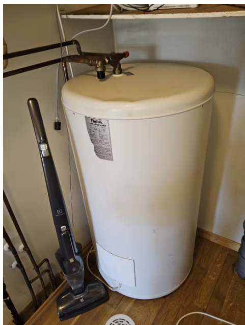
Varmtvannsbereder er plassert på bod.
