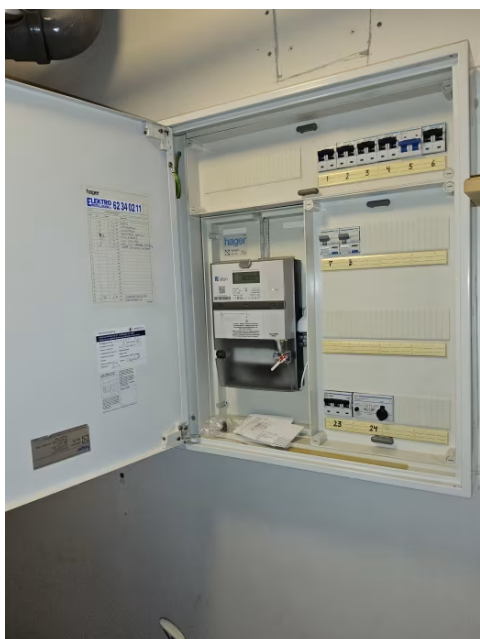
Sikringskap er plassert i bod.
