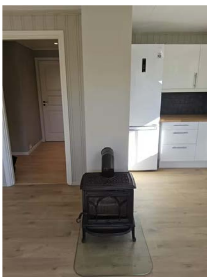
Vedovn tilknyttet elementpipe i stue.
