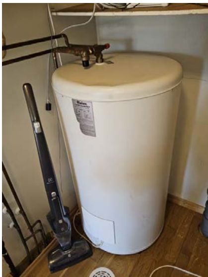
Varmtvannsbereder er plassert på bod.
