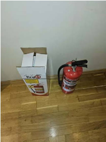
Brannslukningsapparat er plassert på bod.
