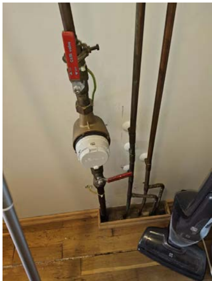
Hovedstoppekran er plassert på bod.
