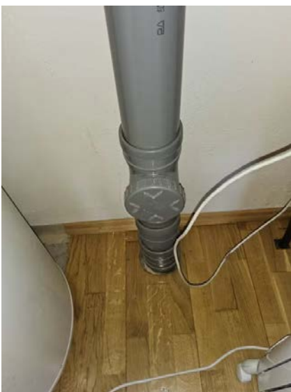
Stakeluke er plassert på avløpsstamme i bod.
