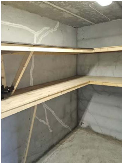
Det registreres riss/sprekker på grunnmur i sportsbod.
