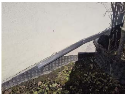
Bilde viser løs topplst og skadet knotteplast.
