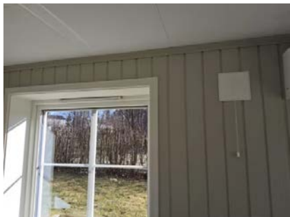
Naturlig ventilasjon med klaffventiler på vegg og spalteventil i vinduer.
