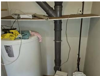
Det registreres riss/sprekk på grunnmur i bod.
