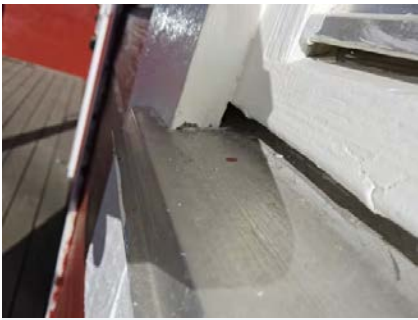
Ingen klaring mellom utvendig belistning og vannbrettbeslag.
