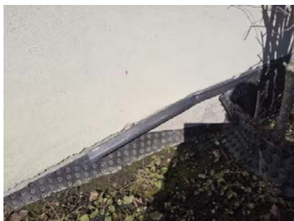
Bilde viser løs topplst og skadet knotteplast.
