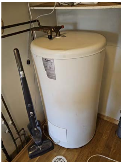
Varmtvannsbereder er plassert på bod.
