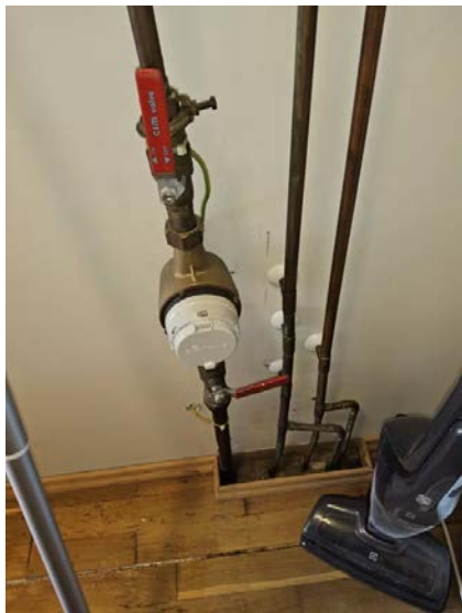
Hovedstoppekran er plassert på bod.
