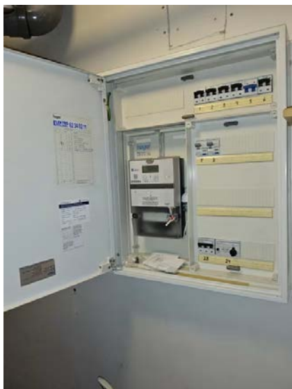
Sikringsskap er plassert i bod.
