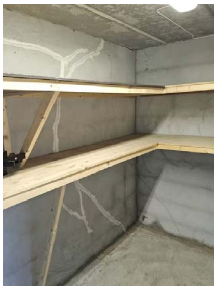
Det registreres riss/sprekker på grunnmur i sportsbod.
