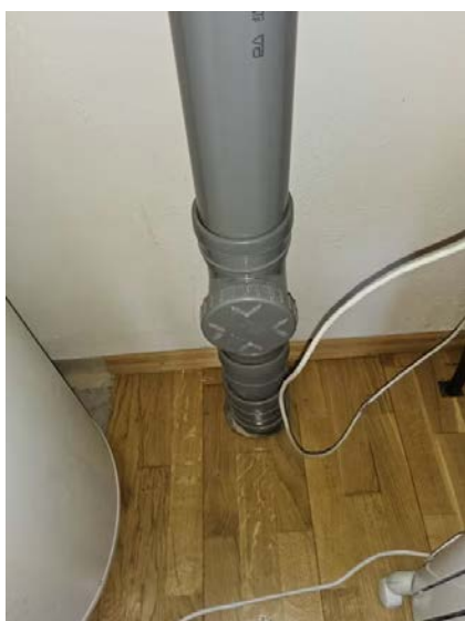
Stakeluke er plassert på avløpsstamme i bod.
