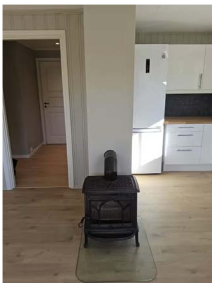
Vedovn tilknyttet elementpipe i stue.
