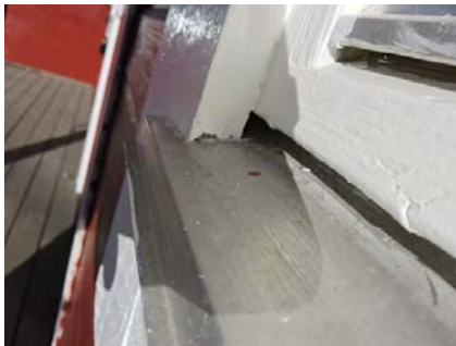
Ingen klaring mellom utvendig belistning og vannbrettbeslag.
