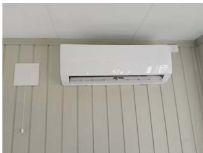
Varmepumpe er plassert i stue.
