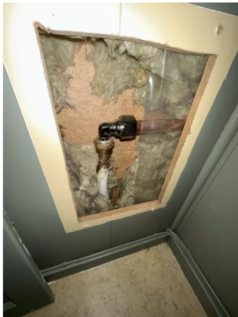
Luke på soverom. Rørføring til utekran.
