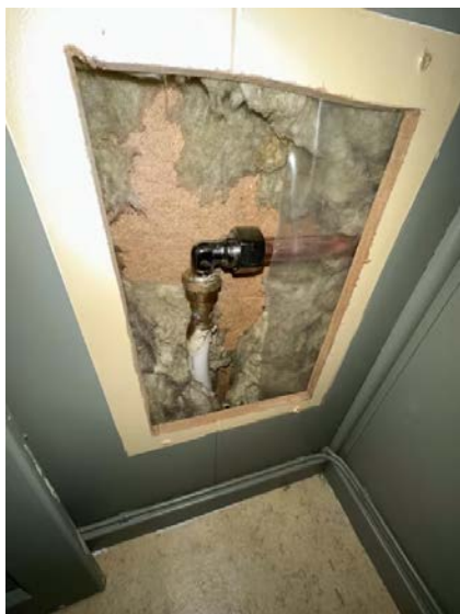
Luke på soverom. Rørføring til utekran.
