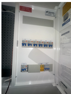
Sikringsskap med automatsikringer.
