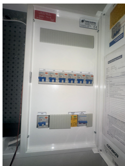
Sikringsskap med automatsikringer.
