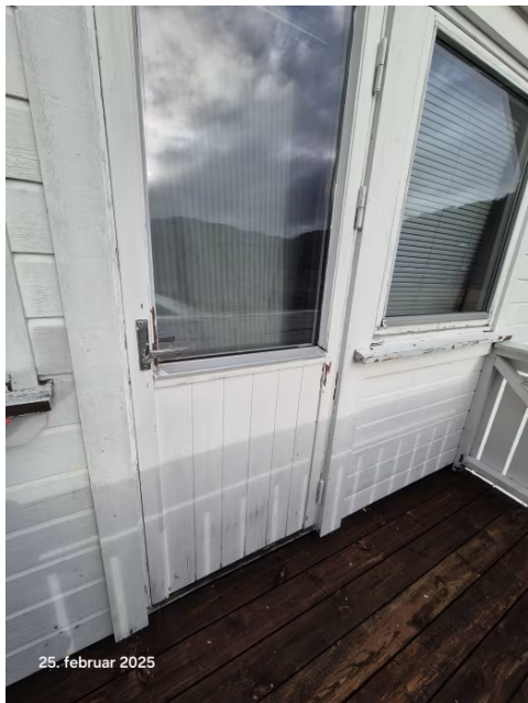
Eldre balkongdør, værslitt.
