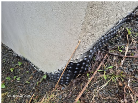
Bildet viser manglende topplast/klemlist på platon/grunnmursplast.
