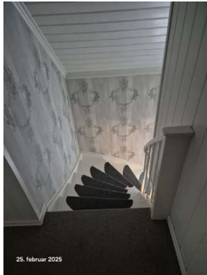
Håndløper vegg mangler.
