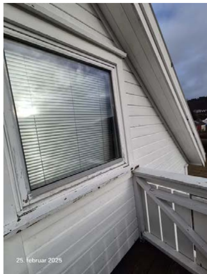
Eldre vindu som også er værslitt.
