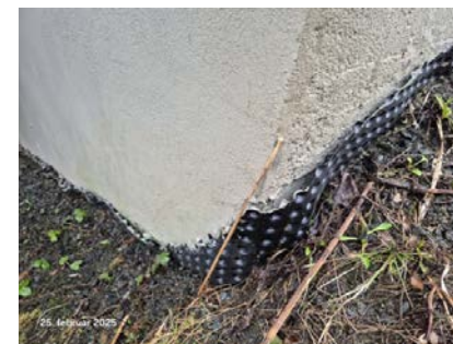
Bildet viser manglende topplst/klemplst på platon/grunnmursplast.
