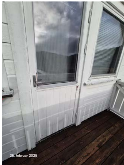
Eldre balkongdør, værslitt.
