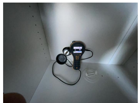
Fuktmålinger i vegg på soverom mot dusj.
