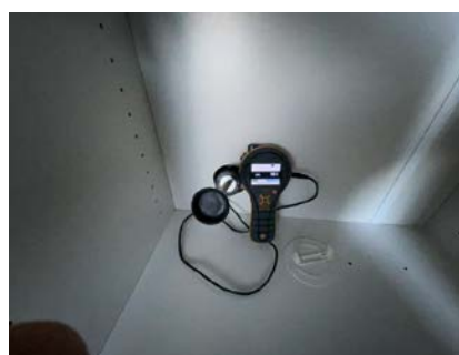
Fuktmålinger i vegg på soverom mot dusj.
