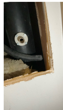
Felles soillrør i plast observert bak utforet vegg i bod.
