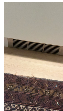
Utluft fra avtrekk i koketopp etablert i sokkel.
