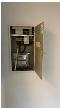
Hovedsikringer og aut. el. måler etablert i felles gang.
