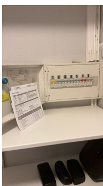
El. skap med automatsikringer etablert i bod.
