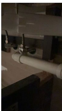
Vann- og avløp på vegg i servantinnredning på bad.
