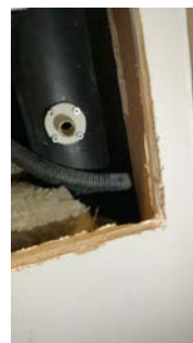
Felles soilrør i plast observert bak utforet vegg i bod.
