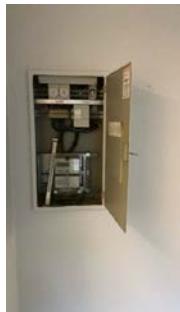
Hovedsikringer og aut. el. måler etablert i felles gang.
