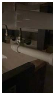
Vann- og avløp på vegg i servantinnredning på bad.
