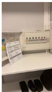
El. skap med automatsikringer etablert i bod.
