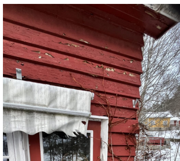
Løsnet kledning, råteskader i raftekasse
