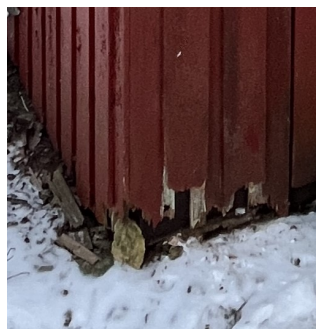
Råteskader og kledning ned under terreng
