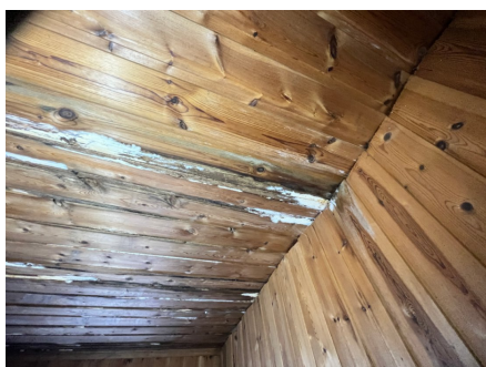
Skader på himling loft
