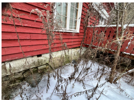
Sprekker og setningsskader.
