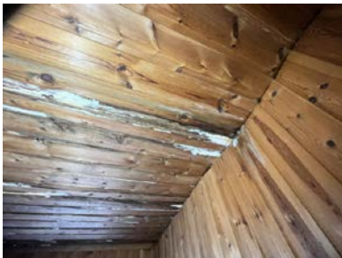
Skader på himling loft
