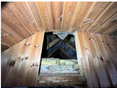
Fuktskader i bordtro
