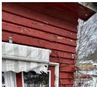
Løsnet kledning, råteskader i raftekaske
