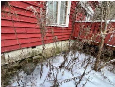
Sprekker og setningsskader.
