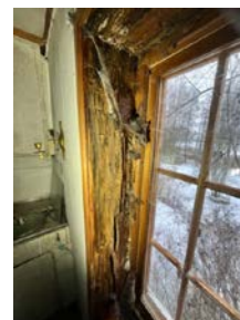
Råteskader på veggkonstruksjon
