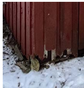
Råteskader og kledning ned under terreng
