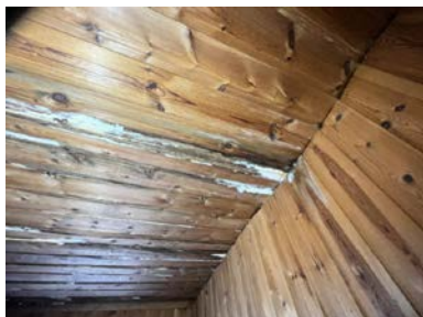
Skader på himling loft
