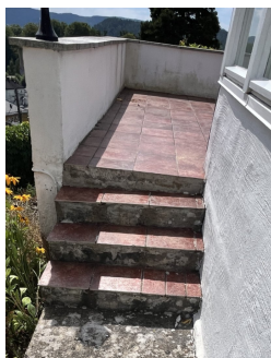
Ulik høyde på opptrinn, korte inntrinn
