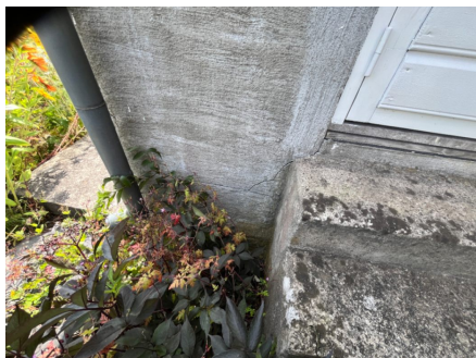
Sprekk i mur på innbygd balkong
