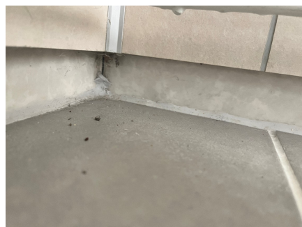
Ikke fuget i underkant på veggplater.
