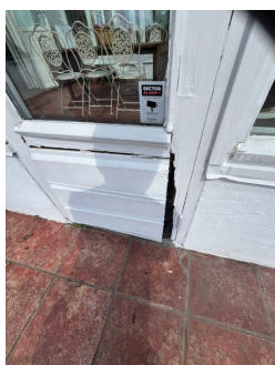
Råteskade på dør, innglasset terrasse
