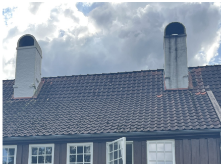
Rust på sokkelbeslag
