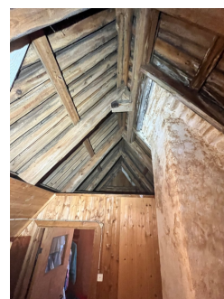
Fuktmerker ved pipe gjennomføring, tørt nå
