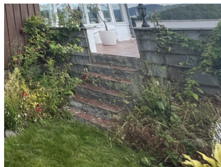
Ulik høyde på opptrinn, korte inntrinn
