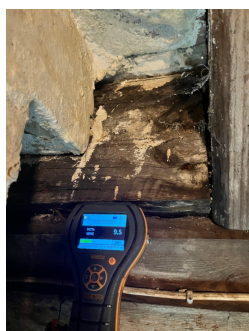
Fuktmerker ved pipe gjennomføring, tørt nå
