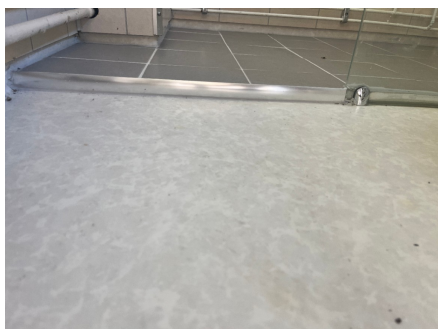
Oppkant ved dusjnisje
