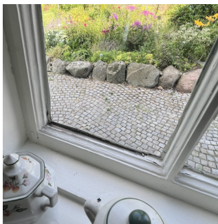
Vindu på kjøkken med enkelt glass, merker etter kondensvann
