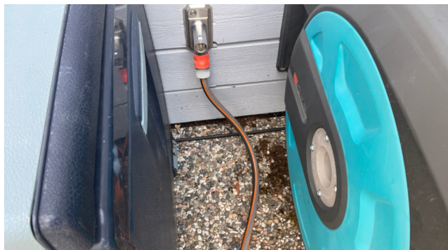
Bordkledning nesten helt ned i terrenget.
