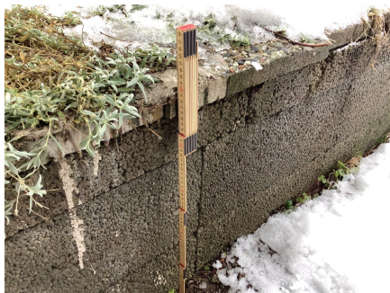
Forstøtningsmur er ikke sikret med rekkverk.
