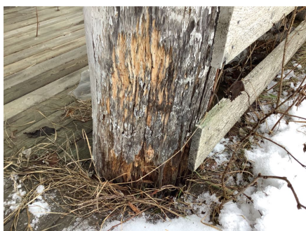
Råteskader i bærende stolpe.
