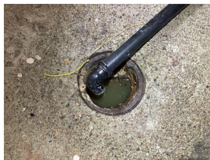
Støpejernsluk, uten tettesjikt på gulv.
