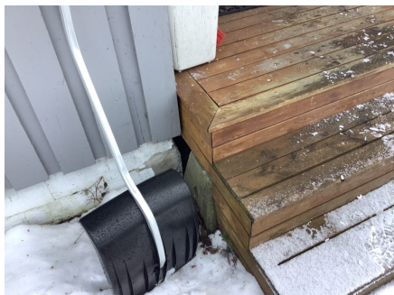
Trapp mangler rekkverk.
