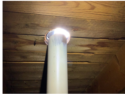
Det er utettheter rundt luftehatt.
