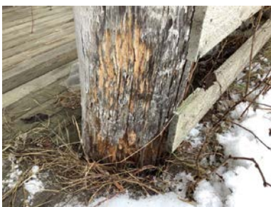
Råteskader i bærende stolpe.
