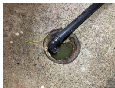
Støpejernsluk, uten tettesjikt på gulv.
