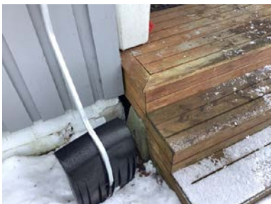
Trapp mangler rekkverk.
