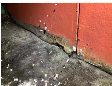
Fuktskader i nedkant av plater rundt badekar.
