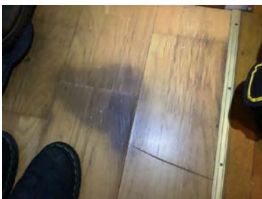
Fuktskadet parkettgulv i gang.
