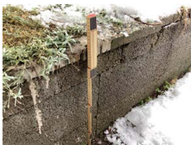
Forstøtningsmur er ikke sikret med rekkverk.
