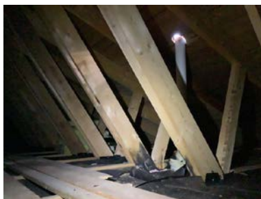
Det er utett gjennomføring i takflaten.
