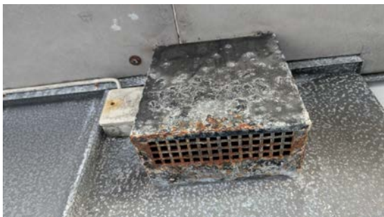
Rust på ventilhet.
