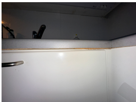
Svelling i benkeplate
