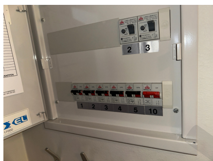
Sikringsskap med automatsikringer.
