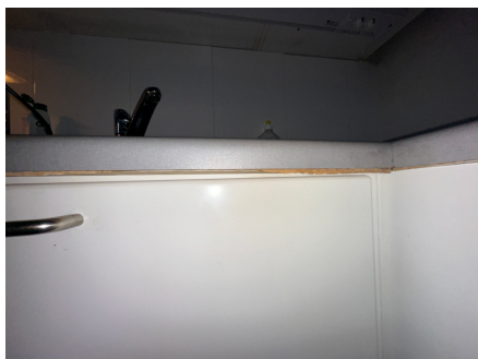
Svelling i benkeplate
