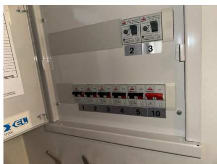
Sikringsskap med automatsikringer.
