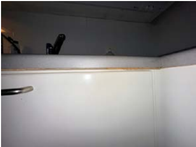
Svelling i benkeplate
