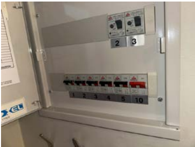
Sikringsskap med automatsikringer.
