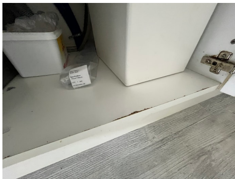
merker etter fukt
