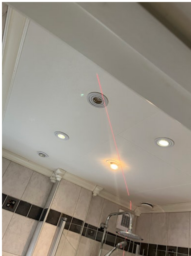
Ødelagte downlights i himling
