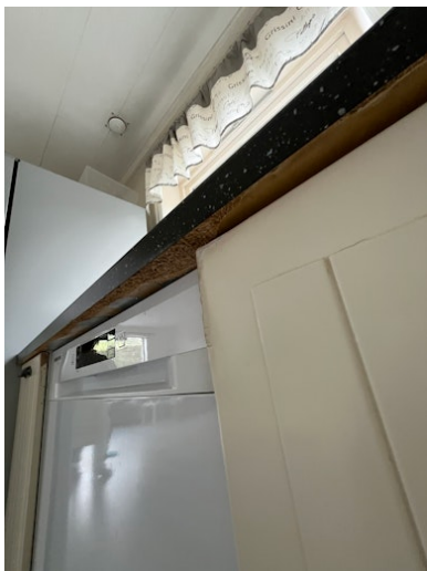
fukt skader på underside av benkeplate
