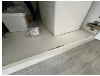
merker etter fukt
