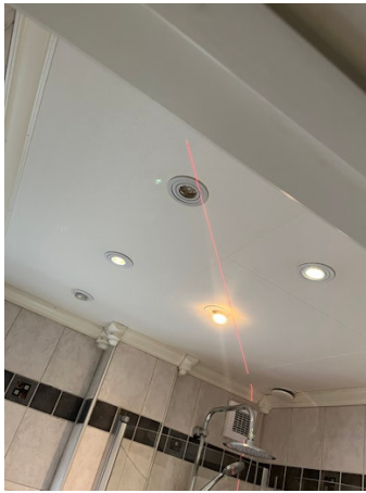
Ødelagte downlights i himling
