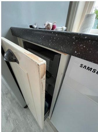
høy grad av slitasje på innredning
