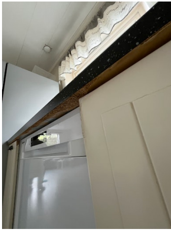
fukt skader på underside av benkeplate
