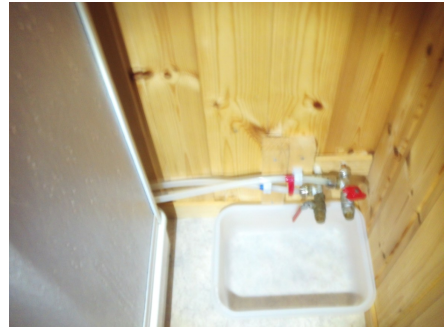
Plastrør på dusjrom.
