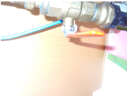
Innvendig stoppekran i kjøkkenbenken.
